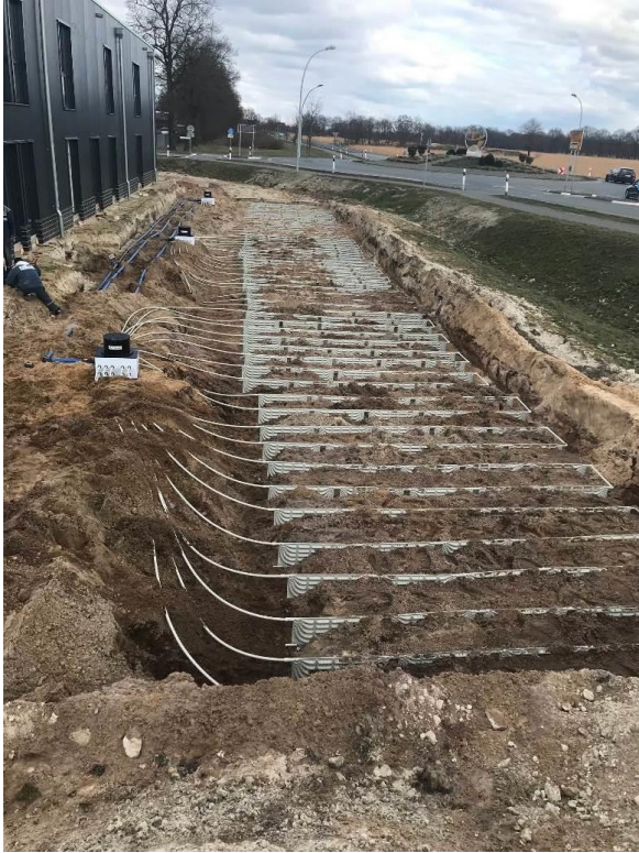
Die GeoCollect-Anlage mit 40 Strängen je 10 Kollektoren nutzt die Randfläche zur benachbarten Straße. Die Versickerung des Niederschlagswassers erhöht die Entzugsleistung, spart Abwasserkosten und schont die Umwelt. Foto: vor dem Brocke
