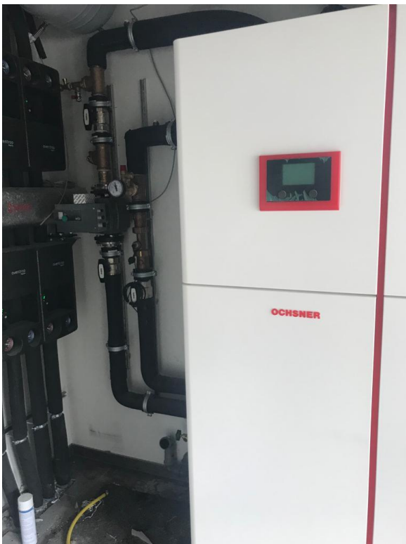
Herz und Hirn der Wärmeversorgung ist die Wärmepumpe TERRA 40 CPLA von Ochsner mit 40 kW Leistung. Foto: vor dem Brocke
