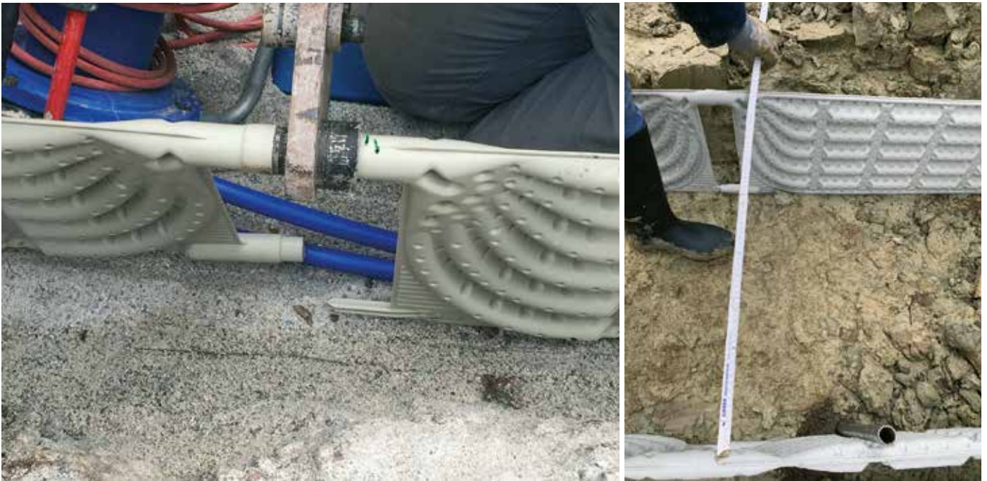
Verlegung und Anschluss der Kollektoren. Ein Abstand der turbulent durchströmten Absorber von 70 cm gewährleistet eine optimale Entzugsleistung und thermische Regeneration des Erdreichs.
