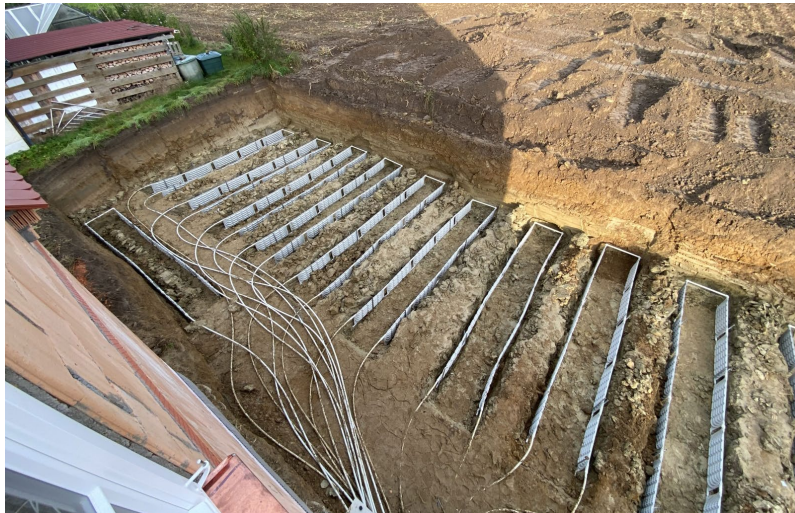
Eines der Projekte von Ibele Gebäudetechnik: Das Kollektorfeld umfasst etwa ein Drittel der beheizten Wohnfläche. Zehn GeoCollect-Module bilden einen Strang, der an den Verteiler angeschlossen ist.
