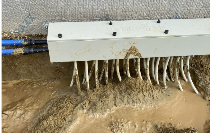
Der Verteiler ist leicht zugänglich an der Bodenplatte montiert. Links die Soleleitungen von und zur Wärmepumpe.
